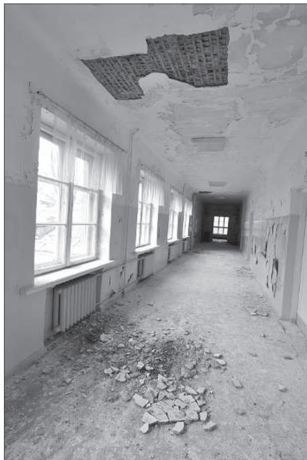
В коридоре с потолка уже начала сыпаться штукатурка.
