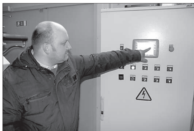
Каспар Путниньш говорит, что оператору не обязательно присутствовать в котельной каждый день.
