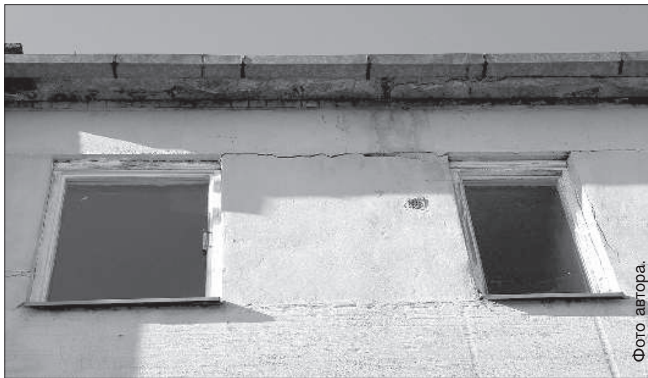
От плохого состояния крыши начинает разрушаться и сам дом по адресу Дарза, 53.
