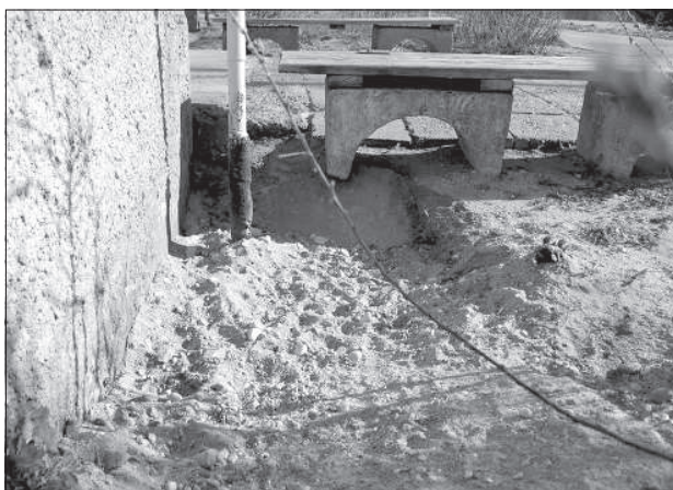
Место провала отмостки рядом с газопроводом.
