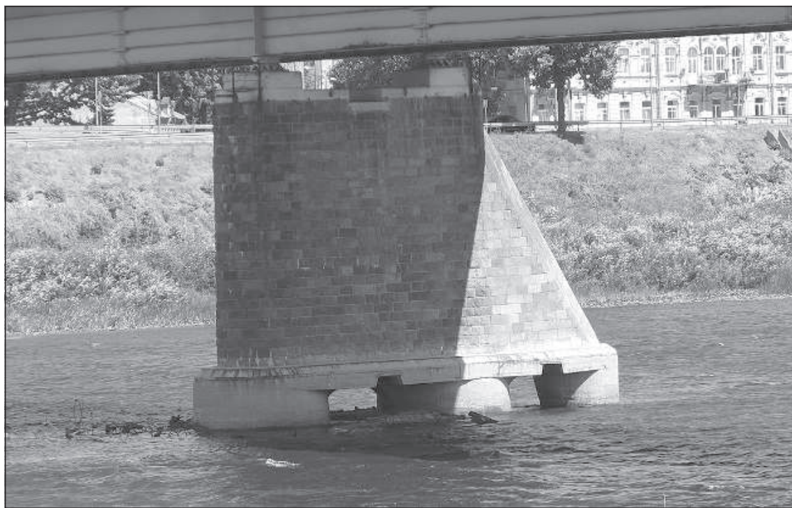
Опоры моста обнажены.
