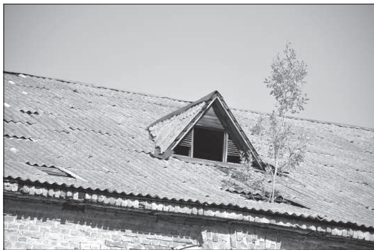
Сквозь разрушенную крышу проросли деревья.
