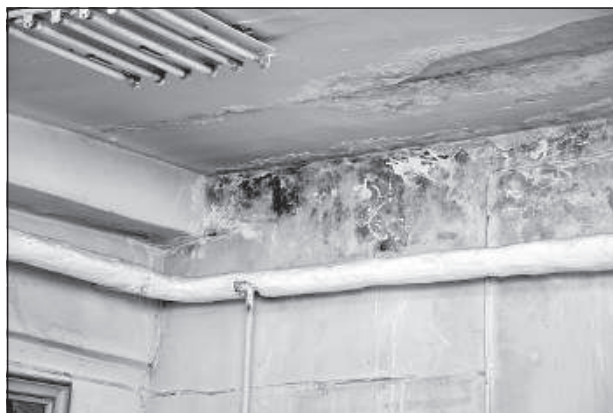
Покрытые плесенью стены и потолок с падающей штукатуркой.
