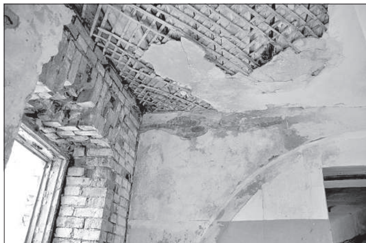
Перекрытие между этажами местами начинает рассыпаться.
