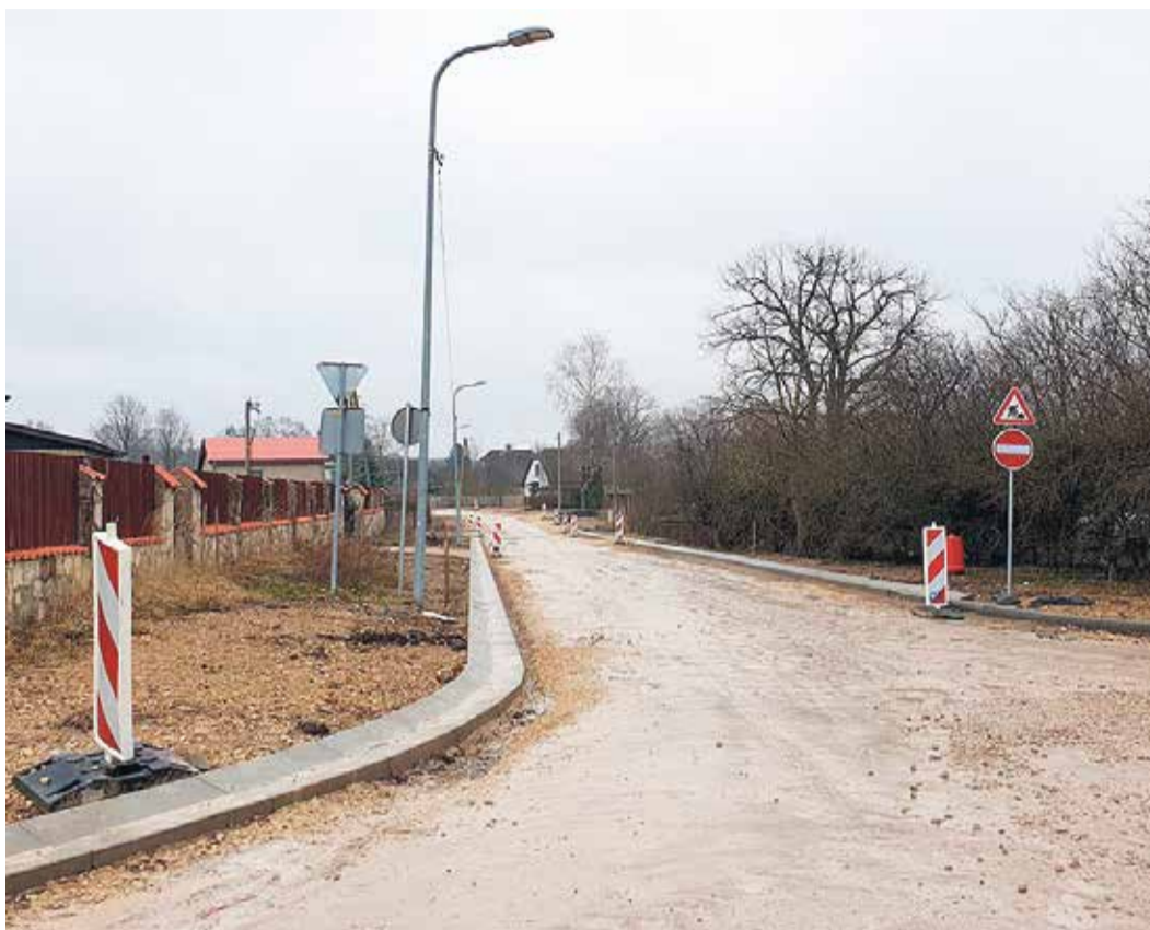
Lai arī pašvaldība vairākkārt ir pieprasījusi būvniekam uzturēt būvobjektu ielai atbilstošā kvalitātē, tas pildīts tikai daļēji, tādēļ pārvietošanās pa Upes ielu un Jūras prospektu ir apgrūtināta. Foto: no Saulkrastu domes arhīva
