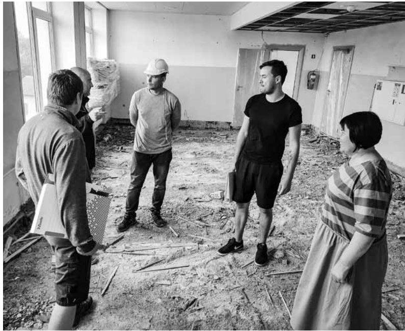
Kuldīgas 2. vidusskolas direktore Guntra Buivida ar strādniekiem apspriež remonta gaitu. Darbu plānots beigt janvārī.
