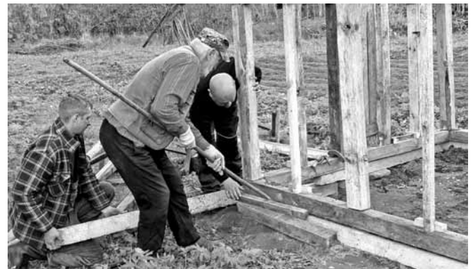
Mazormaņu saimnieks Juris kopā ar draugiem Jāni un Didzi no z/s "Ošāni" būvē siltumnīcu. Tajā izaudzēto izmanto arī tūristu maltītēm.
