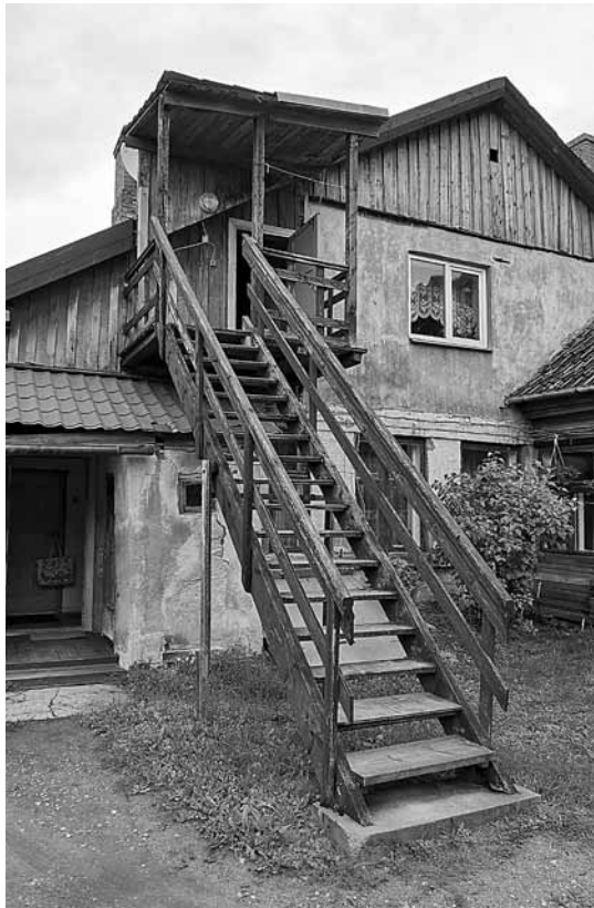
Jelgavas ielā 29 pa šīm kāpnēm diendienā staigā cilvēki gados. Īpaši bīstami tas ir lietainā un sniegotā laikā.
