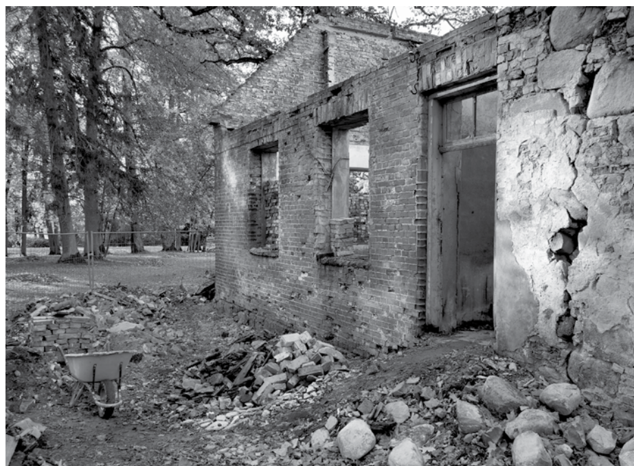
Vārmes muižas klēts ilgus gadus bijusi pamesta un avārijas stāvoklī, tādēļ, lai pēc jumta nojaukšanas saglabātu vismaz mūrus, tie tiks iekonservēti.
