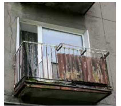
Pastiprināta uzmanība ir jāpievērš balkonam norobežojošo konstrukciju tehniskajam stāvoklim, īpaši to stiprinājumam pie ēkas, jo tas var nebūt drošs.
