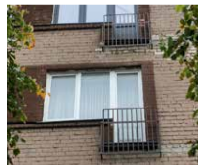
Viens no variantiem ir nedrošo balkonu demontāža. Pēc balkonu demontāžas tiek saglabātas balkona durvis, kuru priekšā izbūvē margas jeb tā saukto franču balkonu. Šādu variantu ir izvēlējušies iedzīvotāji Katoļu ielā 1.
