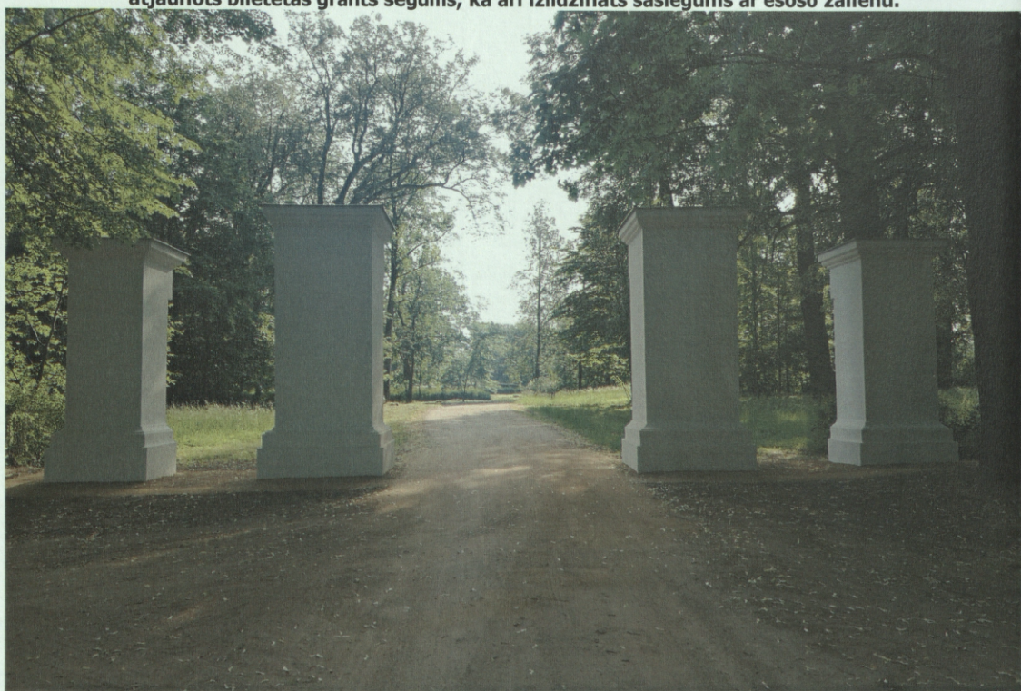
Attēls Nr. 38 Parka vārtu restaurācija pabeigta 11.06.2019 ( skats no ielas puses ) Zem vārtiem un vārtu tuvumā atjaunots blietētas grants segums, kā arī izlīdzināts saslēgums ar esošo zālienu.
