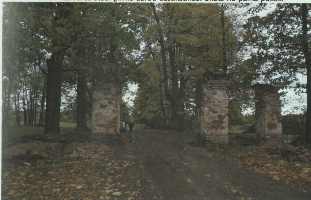
Attēls Nr. 3 Pēc kultūrslāņa un auglīgas kārtas noņemšana redzams saglabājies trūkstošā vārtu staba pamats. Esošā pamata nestspēja, mūrējums un mūrjava nestabila - nestspēju zaudējusi. Saskaņojot ar projekta arhitektu nolēms demontēt nestabilo mūrējumu un veikt pamata veidņošanas, stiegrošana un betonēšanas darbus.
