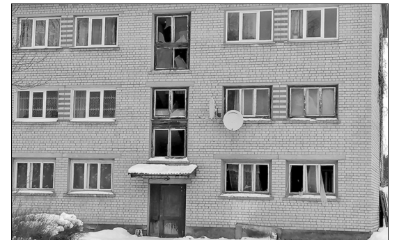
Взрыв в трёхэтажном жилом доме был настолько мощным, что в квартире и на лестничной клетке высыпались окна.
