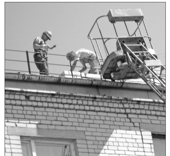
Rancāna ielas 1. mājai pārmūrēti ventilācijas skursteņi.
