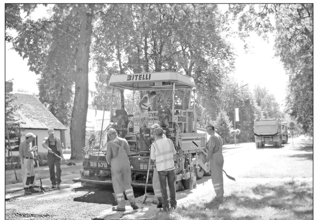
Asfaltbetona segums atjaunots vairākās ielās, kur pabeigta apakšzemes komunikāciju izbūve. Attēlā: asfalta ieklāšana Raiņa bulvārī.
