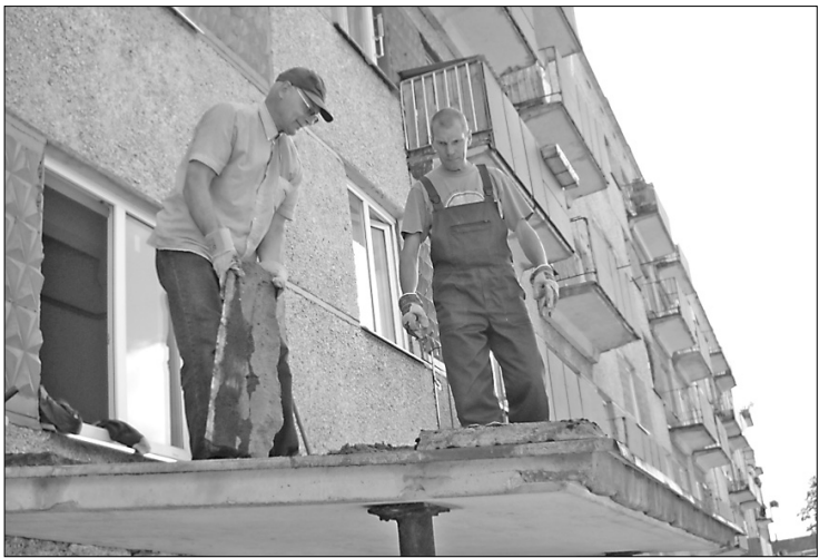
Daudzdzīvokļu mājai Rēzeknes ielā 30 visām sekcijām tiek mainīti lieveņu jumti, kas kalpojuši kopš mājas uzcelšanas. Attēlā: vecā seguma noņemšanu veic Juris Limans un Ilgvars Maksimovs.
