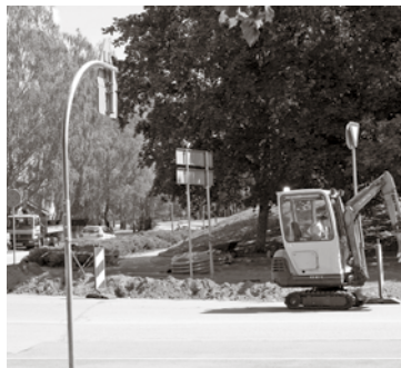
Uzsākti darbi pie luksofora uzstādīšanas Rīgas un Jūrmalas ielas krustojumā Piņķos (I. Aizsila foto)
