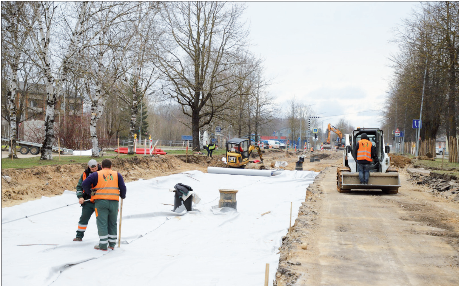
Apjomīgākie būvdarbi šobrīd norit Gaismas ielā pie Viršu degvielas uzpildes stacijas, kur šonedēļ tika klāta ceļa slāņus atdalošā kārtā. Augustā, kad šī posma rekonstrukcija būs pabeigta, viena no nozīmīgākajām Aizkraukles ielām būs pilnībā atjaunota visā tās garumā. Foto: A. Upīts
