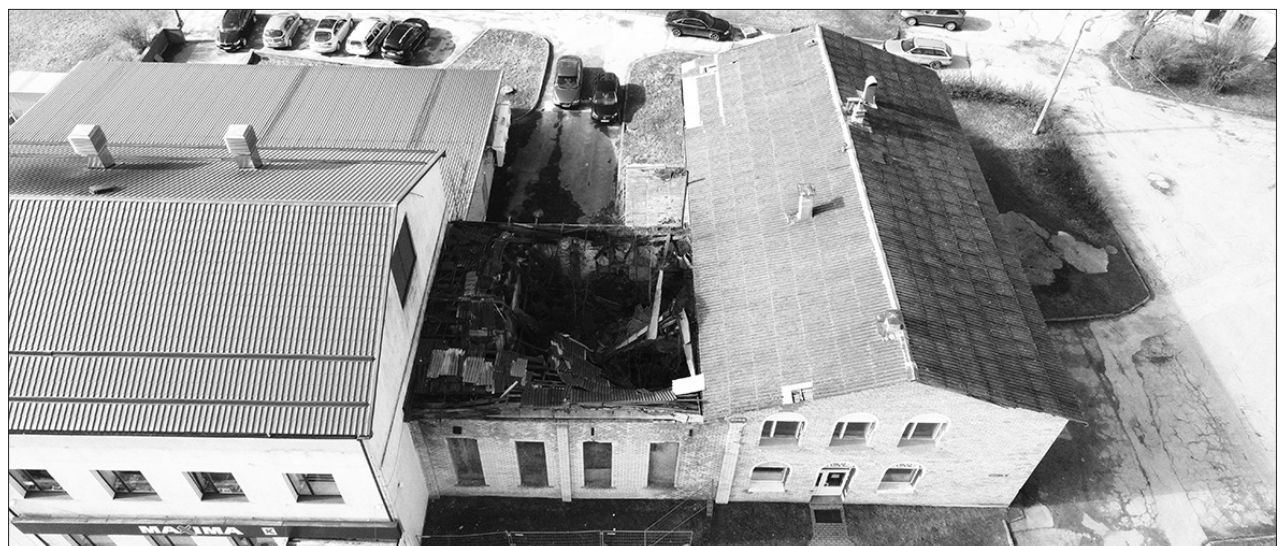
Ēkas īpašniekam uzdots noteiktos termiņos veikt ārsienu un bīstamo konstrukciju sakārtošanu, kā arī iesniegt ēkas pārbūves projektu.
