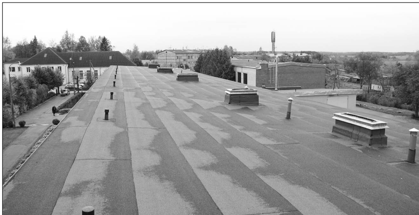
Самые большие финансовые вложения в этом году в Дравниекской основной школе, где полностью заменено покрытие крыши.
