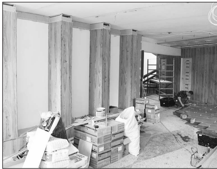
Ремонтные работы на первом этаже административного здания, где расположится единый государственный и муниципальный центр обслуживания клиентов.
