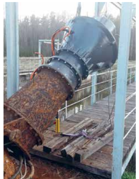
Restaurētais Laveru poldera sūkņu stacijas agregāts
