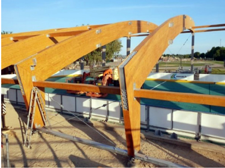
Fig. 7.15. Three-threaded frame (Gada labākā būve Latvijā 2018, 2019. The best building of the year in Latvia, 2019).
