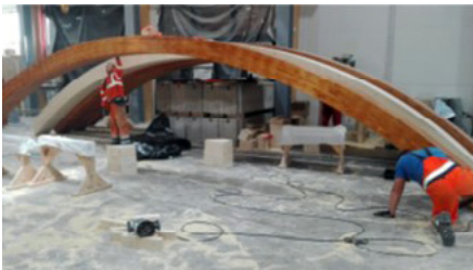
Fig. 7.3. Curved glue-laminated wood arches (Gada labākā būve Latvijā 2017, 2018. The best building of the year in Latvia, 2018).
