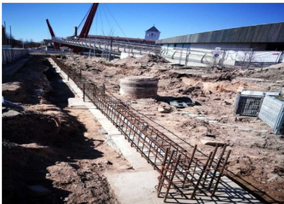
Fig. 7.11. Outside view (construction phase) (Gada labākā būve Latvijā 2018, 2019. The best building of the year in Latvia, 2019).
