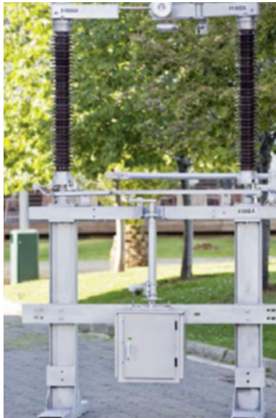
5.7. attēls. Horizontālā tipa 110 kV atdalītājs
