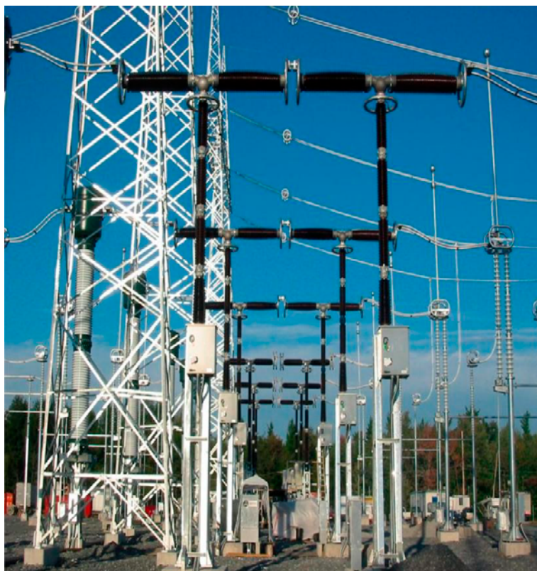
5.1. attēls. Augstsprieguma elegāzes jaudas slēdzis
