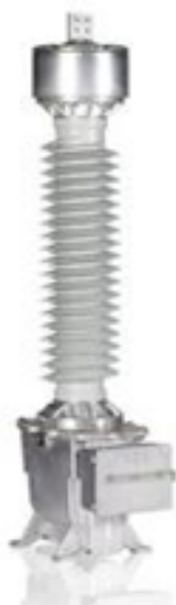
5.33. attēls. 110 kV spriegummaiņi
