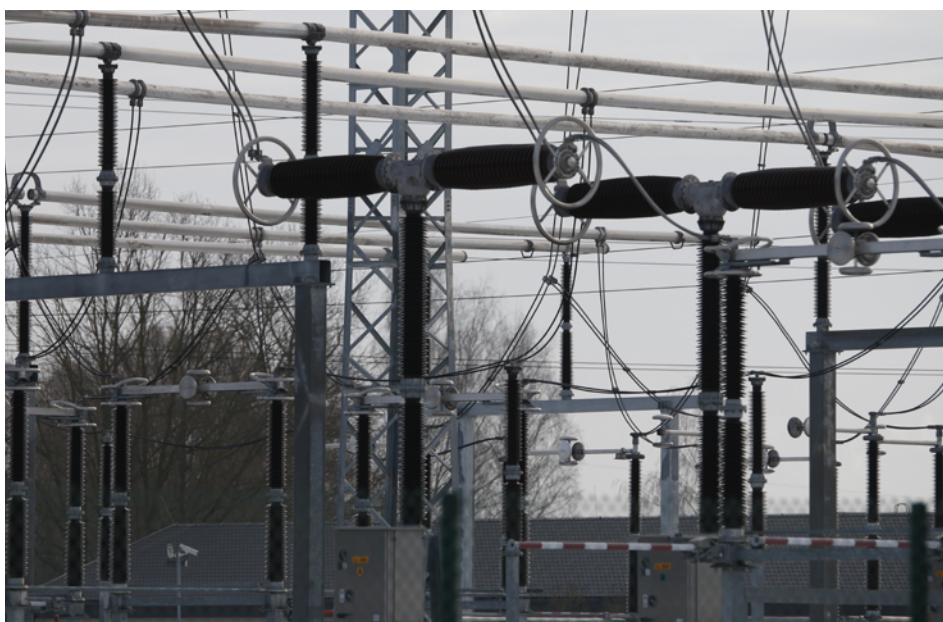
5.2. attēls. 330 kV elegāzes jaudas slēdzis
