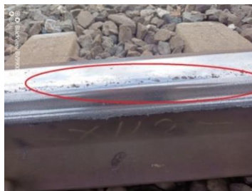
2.3. att. Atklātais defekts līknē R = 708\text{ m} Vecumnieku stacijas 1. galvenajā ceļā.
