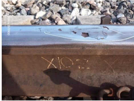
2.2. att. Atklātais defekts sliežu ceļa posmā Menta–Daudzeva 256 km 6 piketā.
