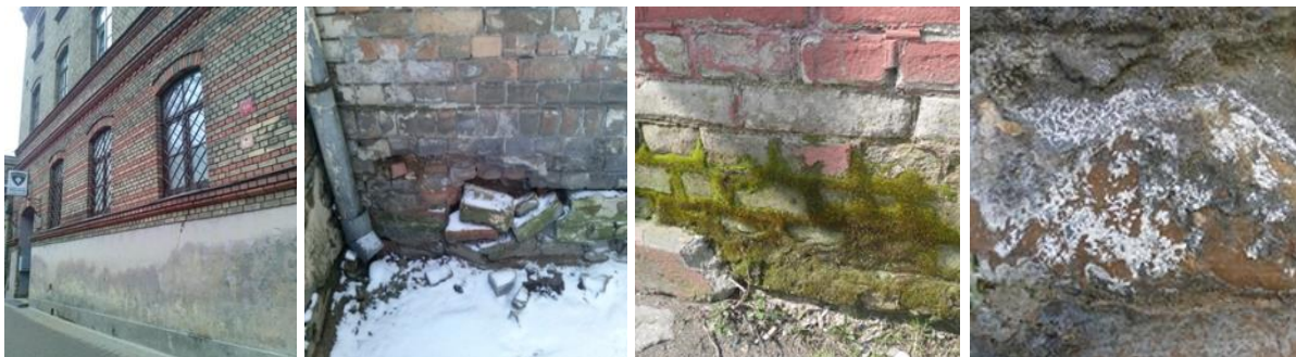
2.2. att. Paaugstināta mitruma izraisīti bojājumi vēsturisko ēku mūros.
