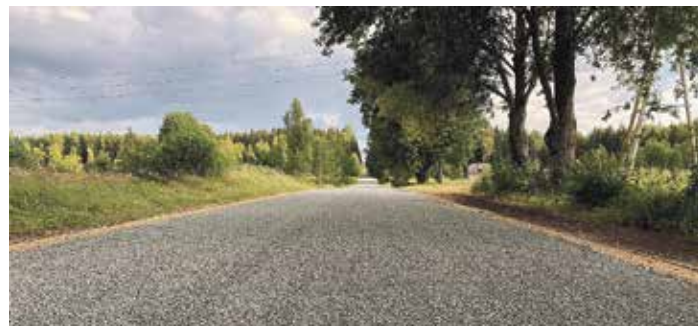
Pašvaldības ceļa 80-92-C8 Murjāņu veikals—Jaunkrimulda dubultās virsmas apstrāde, posma garums – 1,71 kilometrs. Līguma kopsumma (bez 21% PVN) ir 114 018,21 eiro. Foto: Laura Breimane-Tutāne
