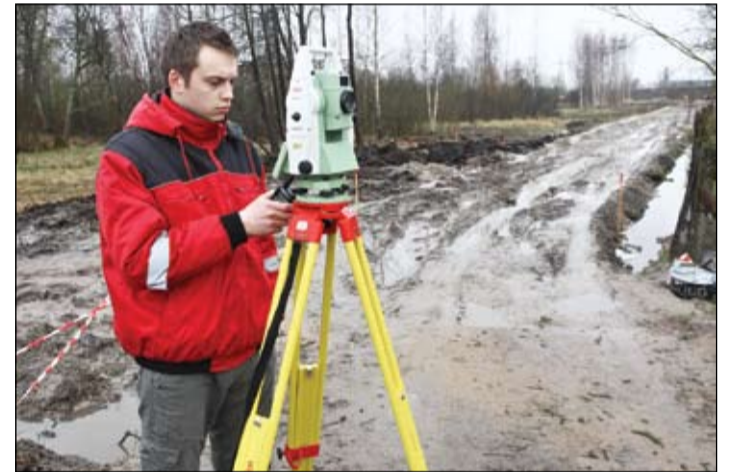
Izbūvējot ūdensvadu uz topošo rūpnīcu, Ziediņu ceļš ir sabojāts un vairs nelīdzinās izbraucamam ceļam, kāds savulaik tas bija.
