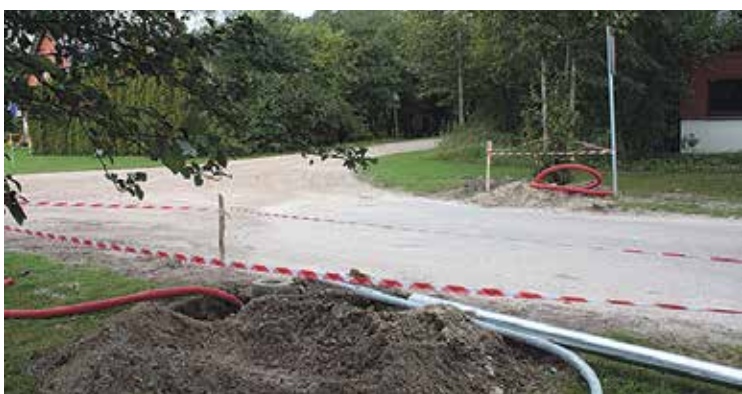
Spuņciemā top apgaismojums Sila ielā.
