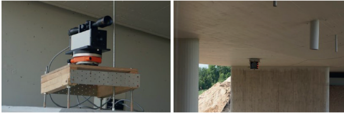
1.2. att. Svārstību sensors Noptel PSM-200 tiek uzstādīts uz tilta pirms pārbaudes ar dinamisku slodzi veikšanas.
