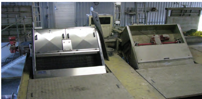
10. attēls. Mehāniskās restes notekūdeņu attīrīšanas iekārtās Liepājā, SIA „Liepājas ūdens” arhīvs
