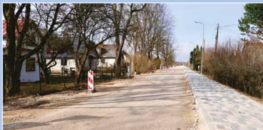
Ziedu ielas rekonstrukcija Ropažos. Projekta izmaksas 1,15 milj. EUR. Būvdarbu veicējs SIA "Vianova".
