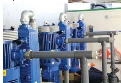
Vakuuma kanalizācijas sūkņu stacija.
