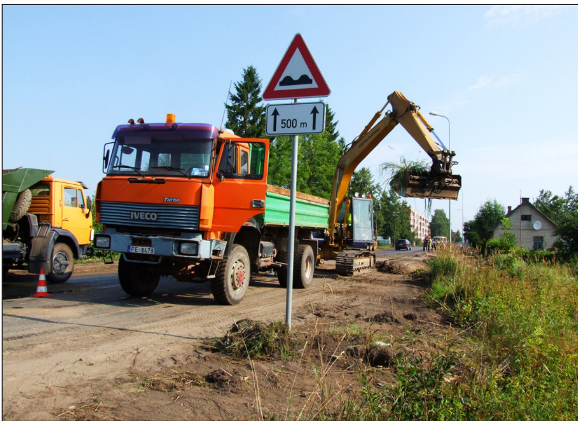
Bērziņu iela Balvu pilsētas pierobežā ir pārvērtusies par būvlaukumu. Kā informēja būvdarbu vadītājs Uldis Mellenbergs, ielas rekonstrukcijas darbus veic 8.CBR būvnieki. Ekskavatori pašlaik norok melnzemi ielas malā. Drīz SIA Purene speciālisti sāks ierīkot apakšzemes komunikācijas, bet kabelus tiks Latvijas energo celtnieks. Būvnieki plāno visas apakšzemes komunikācijas ierīkot līdz ziemeļiem. V. Reķa foto
