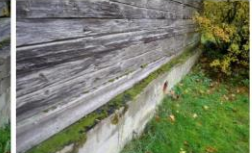
9 att. Lentveida pamati ar ruberoida horizontālo hidroizolāciju ēkas rietumu malā. Spriežot pēc konstrukcijas, visdrīzāk pamati šajā sektorā ekspluatācijas laikā pastiprināti ar betona aizsargkārtu.
