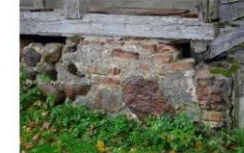
8 att. Ēkas ziemeļrietumu stūrī. Lentveida pamati, ko veido kombinēts māla ķieģeļu un laukakmens mūris. Mūris ar acīmredzamiem izdrupumiem.
