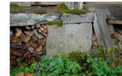
10 att. Ēkas ziemeļu fasādē izbūvēti stabiņveida betona pamati ar šķērsgriezuma laukumiem – 60 x 60 cm.
