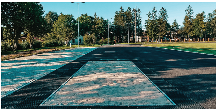
Uzsāka skrejceļa seguma ieklāšanu Carnikavas stadionā. Atbilstoši projektam tiks ieklāti 6 skrejceļiņi ar sintētisko segumu, jau pabeigta asfalta ieklāšana stadionā (t.sk. hokeja laukumā), uzstādīts vingrošanas laukums un izveidots vieglatlētikas sektors.! Foto – Jānis Pārums
