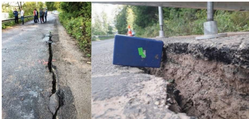
3.4. attēls. Peldu ielas ceļa konstrukcijas deformācijas
