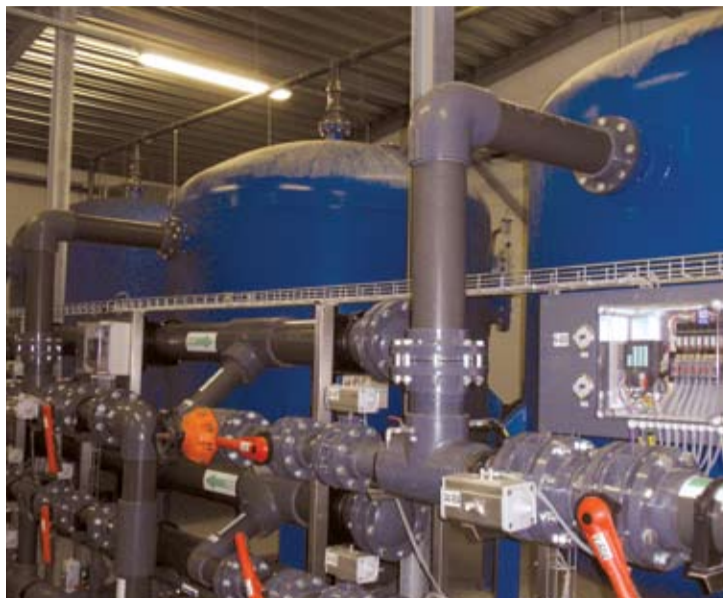
Šajos sešos filtros tiek attīrīts Salaspils iedzīvotājiem piegādātais ūdens.
