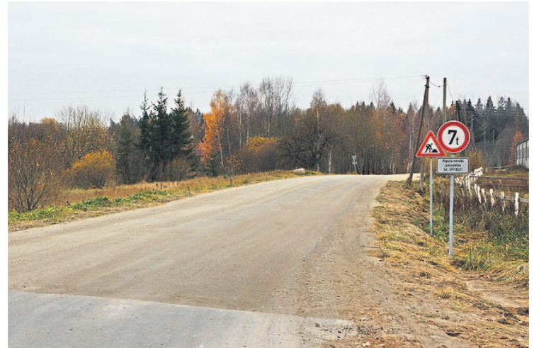
Pēc iedzīvotāju vairākkārtējiem lūgumiem pašvaldība ir atjaunojusi un sakārtojusi pašvaldības piekritīgo ceļa posmu uz Bajāriem. Foto: Inga Koleča
