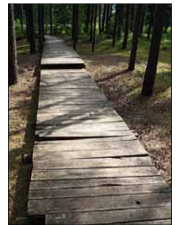
Avārijas stāvoklī esošās laipas Melnsila ielā. Foto no domes arhīva
