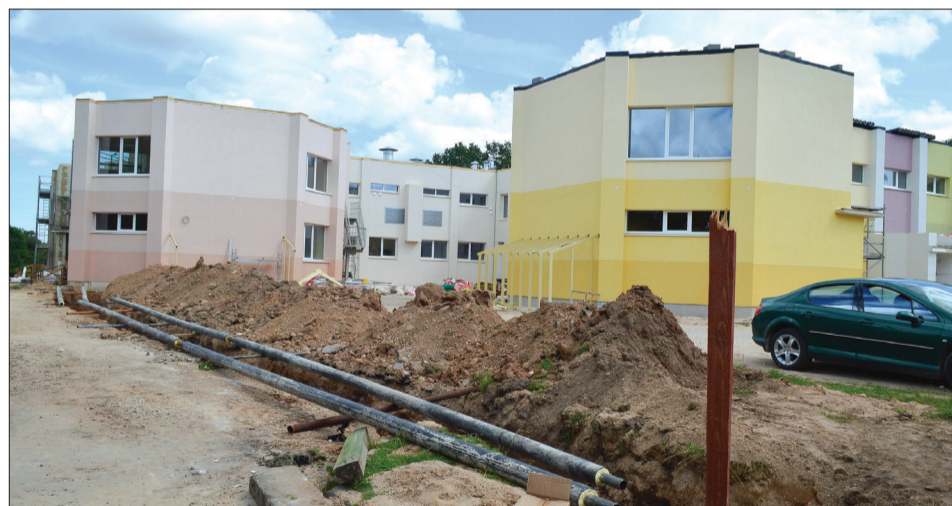
Šī brīža vērienīgākais projekts „Pirmskolas izglītības iestāžu energoefektivitātes paaugstināšana un rekonstrukcija”, kas notiek bijušās Talsu sākumskolas ēkā, kur atradīsies PII „Sprīdītis” Foto: Reinis Mārtinsons
