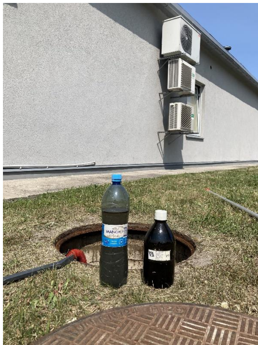
2.attēls. Skats uz ražošanas notekūdeņu attīrīšanas iekārtas ieplūdes aku un ieplūstošā ražošanas notekūdeņu paraugu ņemšanas vietu (10.05.2024)
