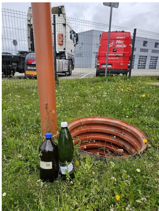
5.attēls. Skats uz ražošanas notekūdeņu attīrīšanas iekārtas ieplūdes aku un ieplūstošā ražošanas notekūdeņu paraugu ņemšanas vietu (10.05.2024.)
