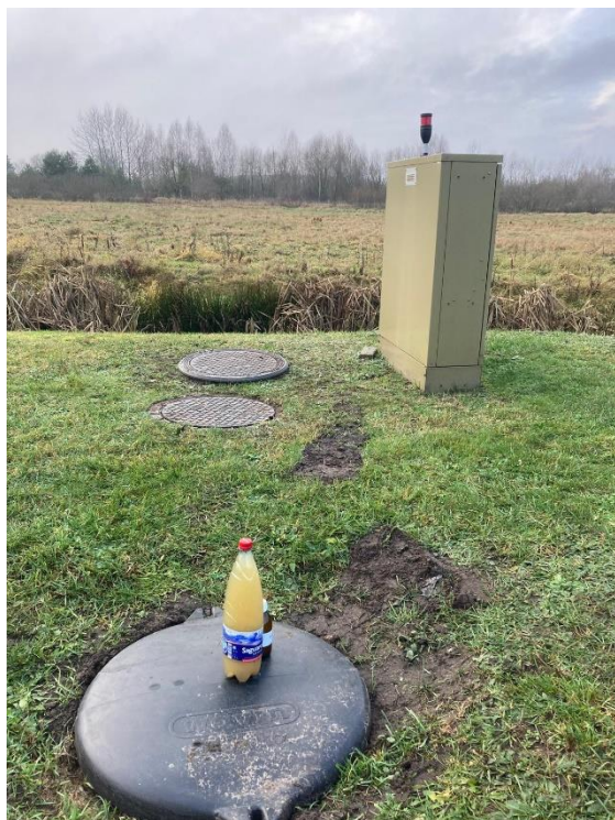
3.attēls. Skats uz sadzīves notekūdeņu attīrīšanas iekārtas ieplūdes aku un ieplūstošā sadzīves notekūdeņu paraugu ņemšanas vietu (28.11.2024.)
