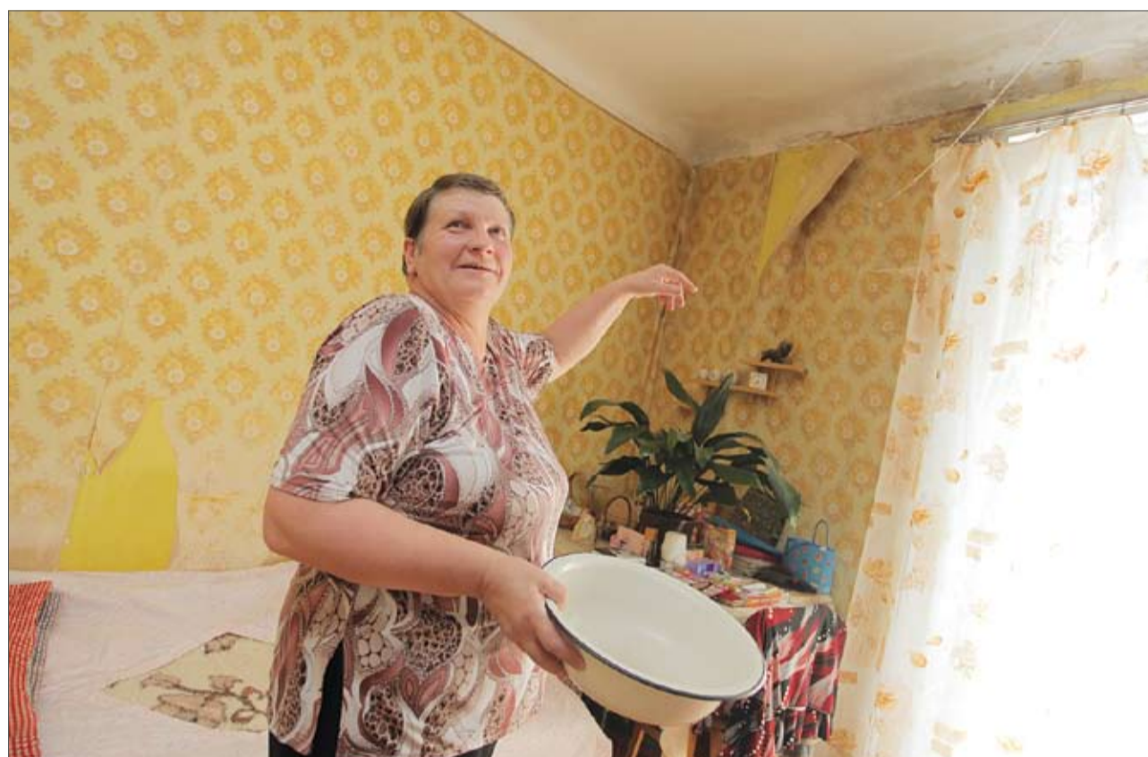
Svētes ielas 24 – 11 iedzīvotāja Olga lietus laikā savā dzīvoklī spiesta izlikt bļodas, lai savāktu ūdeni, kas bojātā jumta seguma dēļ teju strūklā tek no griestiem. Viņa šajā situācijā jūtas bezspēcīga, jo lielākā daļa mājas iedzīvotāju uzskata, ka caurais jumts uz viņiem neattiecas, un tāpēc nav gatavi maksāt par tā nomaiņu.
